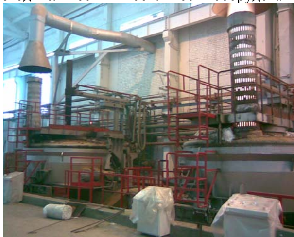
Фото 6. ДППТУ-6АГ - ОАО «Сухоложский завод вторичных цветных металлов» г.Сухой Лог Свердловская обл.
